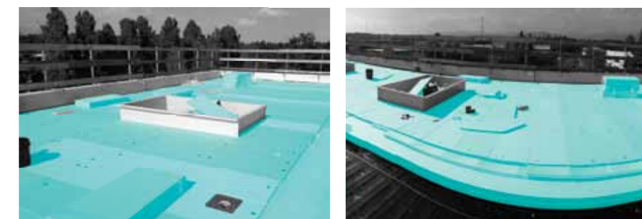
Извођење нагиба FIBRANxps INCLINE плочама и фиксирање плоча FIBRANxps код случаја механички учвршћеног крова, без оптерећења
