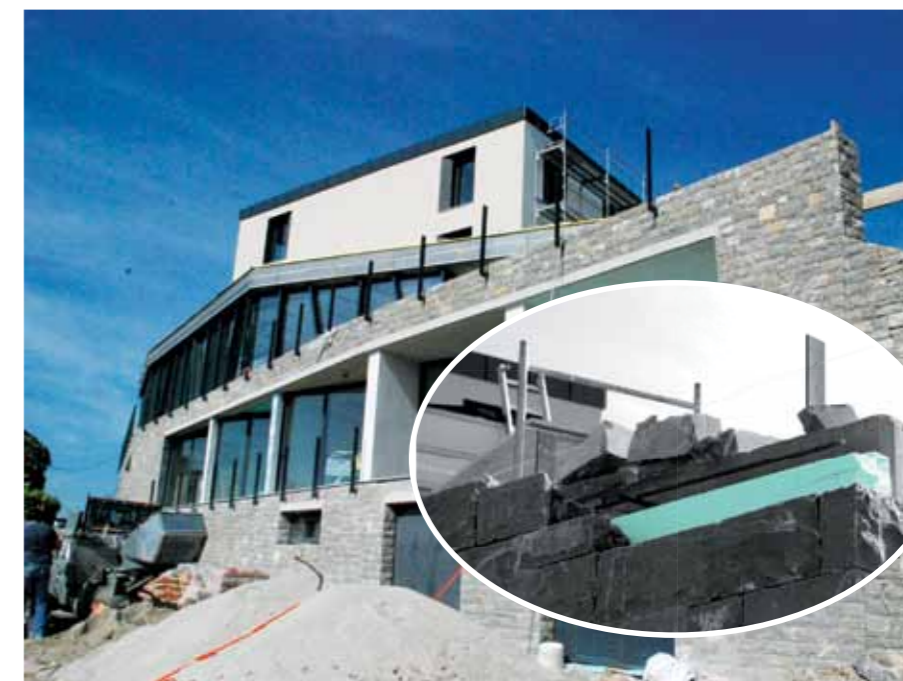
Фасада објекта хотела, обложена каменом, термоизолирана плочама FIBRANxps ETICS BT, на које је посебним поступком залепљен природни камен FIBRANxps
