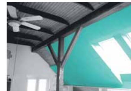
Извођење унутрашње термоизолације плочама FIBRANxps ETICS са танкослојним фасадним системом и завршним декоративним малтером
